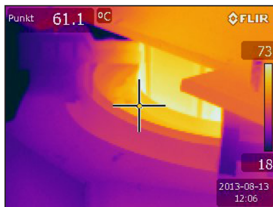
Termografi foto af lavspændingspole på tørtransformer.
