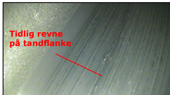
Garantiudløb. Tandskade konstateret i MW gear ved garantiudløb.
